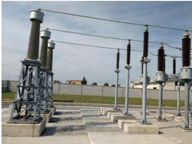
Figura 31 - Entrada da linha AT subterrânea
