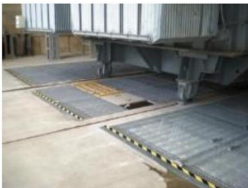
Figura 76 - Exemplo de poço individual ao redor do transformador
