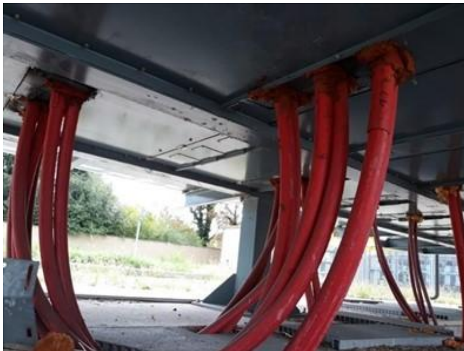
Figura 65 - Cabo MT para o contêiner
