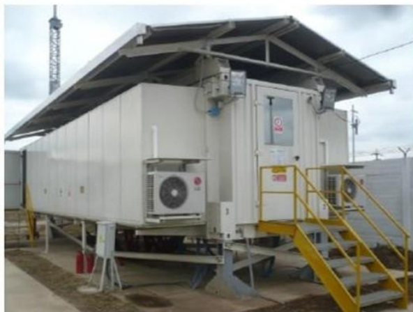
Figura 47 - Exemplo de container instalado no local
