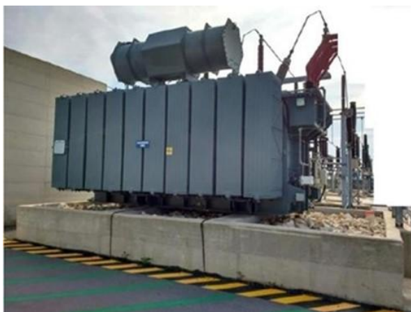
Figura 41 - Lado MT do transformador de potência
