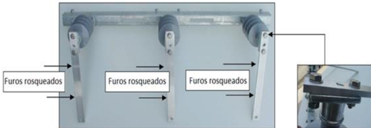
Figura 3: Fixação dos Barramentos
